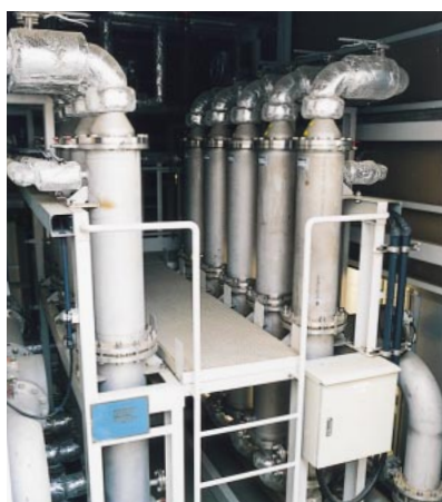
膜方式排水処理装置(半導体グループ那珂事業所)
